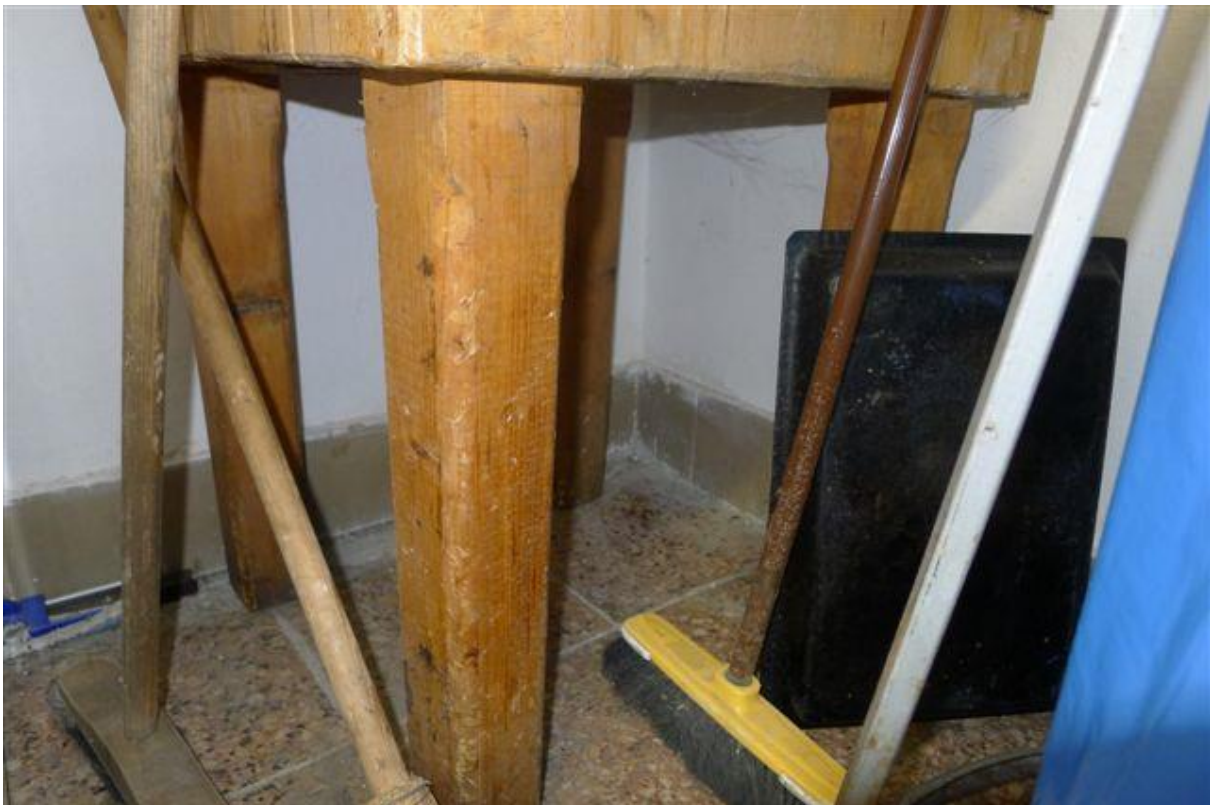
Obrázok č. 52 – M.č.1.03 – kuchyňa - detail soklíkov po obvode, soklíky sú uvoľnené - potrebná výmena
