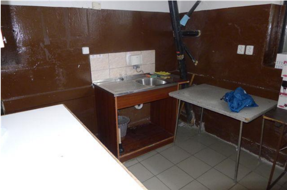
Obrázok č. 21 – M.č.1.18 – spoločenská sála – časť bufetu – nedostatočné zariadenie na dodržanie hygieny
