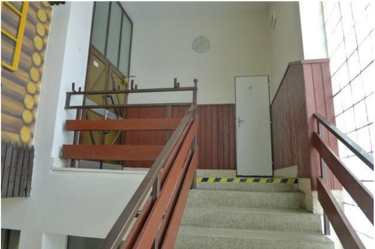
Obrázok č. 20 –M.č.1.14 – chodba-schodisko – detail nevhodného delenia zábradlia, ktoré je nebezpečne. Vodorovné delenie, ktoré vytvára „rebrík“ a medzery sú väčšie ako 120mm. je potrebné opraviť
