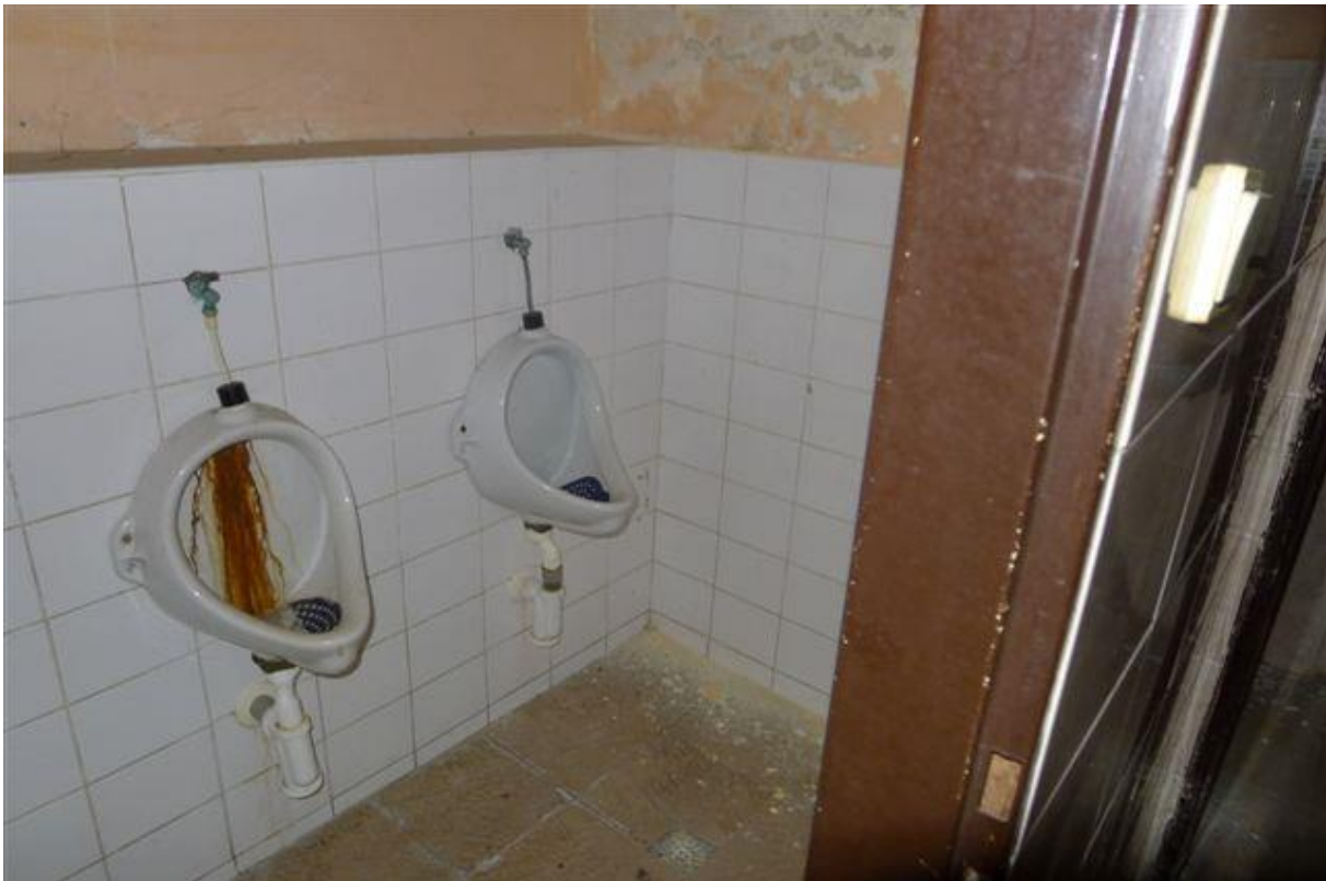
Obrázok č. 4 – M.č.0.04 – WC muži – detail WC – na stenách sú zreteľné stopy po zavlhnutí a poškodenie omietky vlhkosťou, pisoáre sú zanesené a vhodné výmenu.
