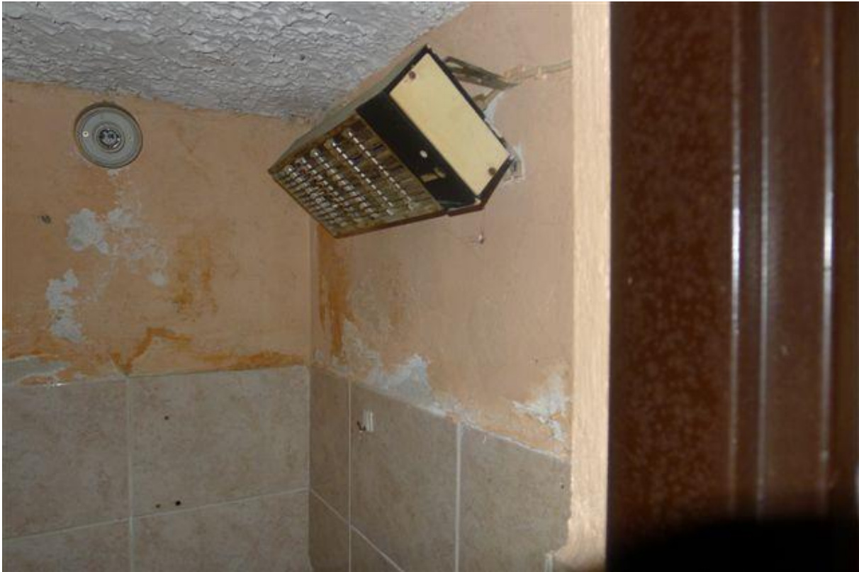
Obrázok č. 3 – M.č.0.02 – detail kúrenia – v nebezpečnej výške – nevyhovujúce
