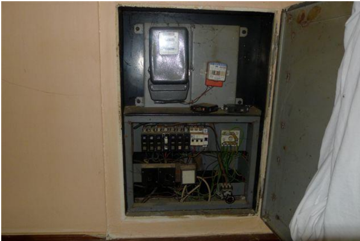
Obrázok č. 9 – M.č.0.06– klubovňa – elektrorozvádzač v nevyhovujúcom stave
