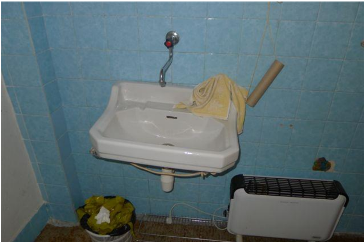
Obrázok č.32 – M.č.1.22 – poškodené obklady na stene v styku s podlahou, je potrebné opraviť
