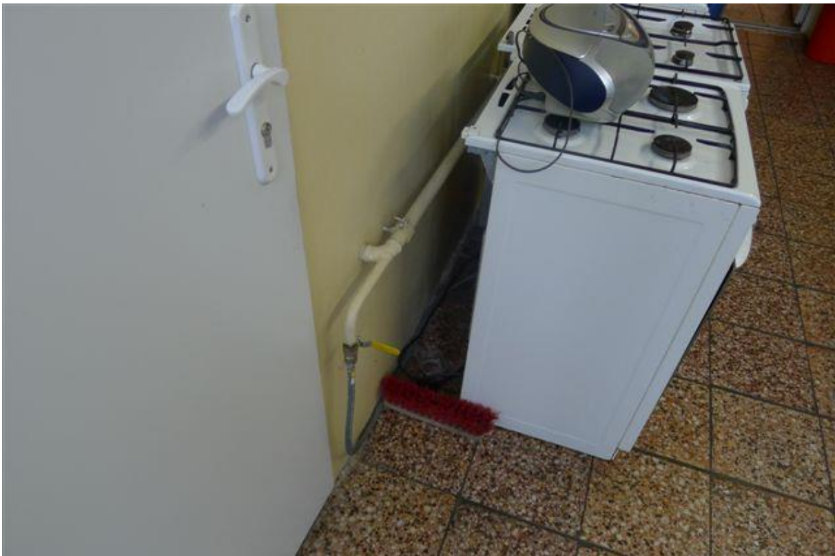
Obrázok č. 14 – M.č.1.03 – kuchyňa – detail napojenia plynových spotrebičov – obťažné čistenie za spotrebičmi – je potrebné uzavretie z vrchnej strany
