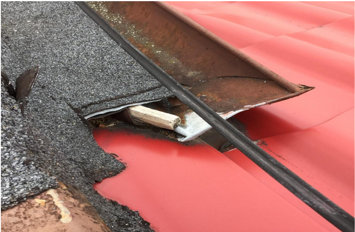
Obrázok č. 62 – strecha pultová - Detaily hydroizolačnej vrstvy okapu a atiky pultovej strechy nie sú riešené podľa technologického predpisu výrobcu krytiny
