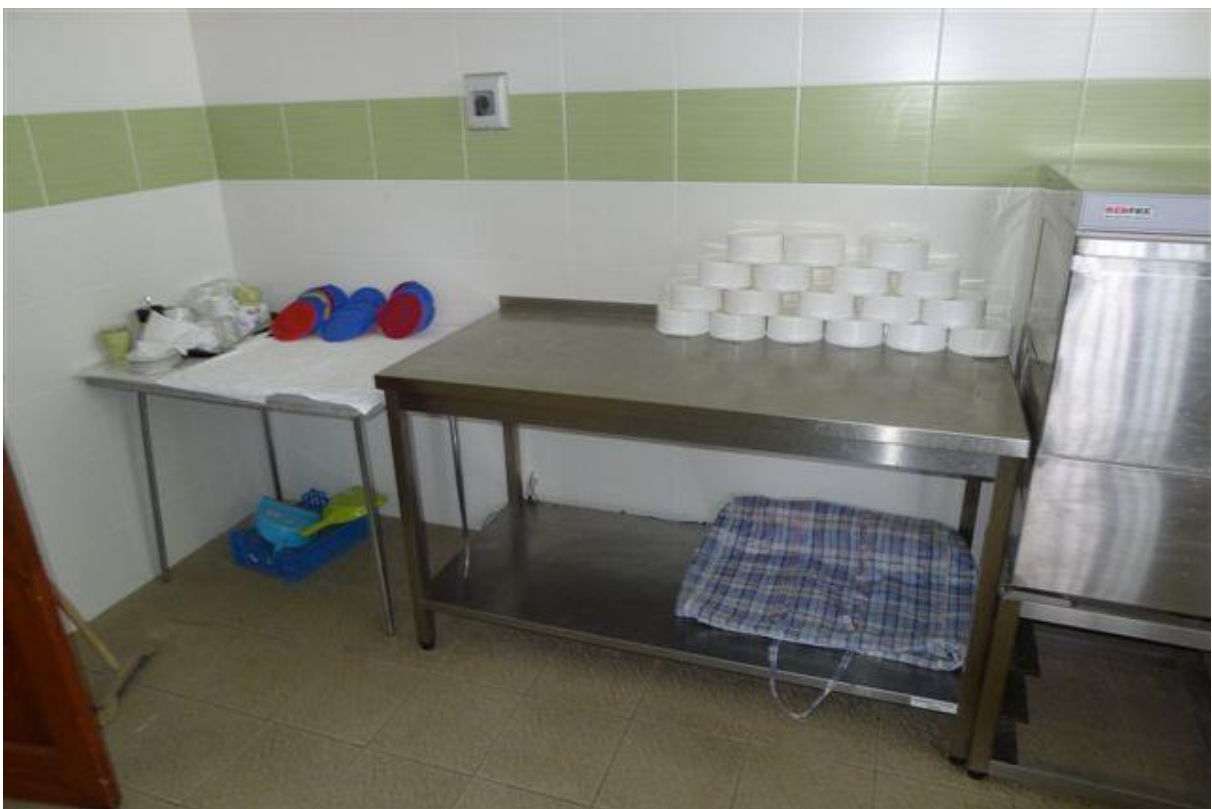
Obrázok č. 46 – M.č.2.10 – kuchyňa – detail dlažby a obkladu je ťažšie čistiteľná preto je treba použiť viac chémie a strojné čistenie
