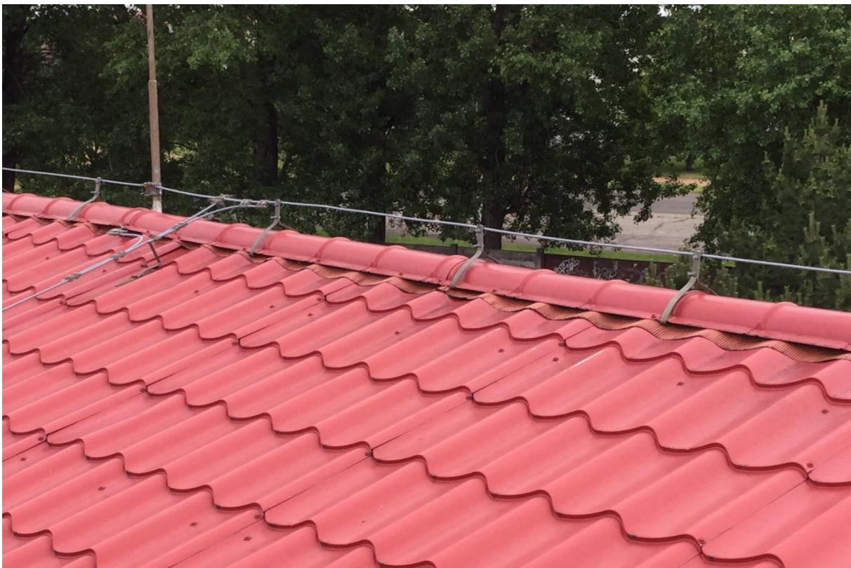
Obrázok č. 66 – strecha sedlová – Ochranná fólia v štíte nie je na niektorých miestach vyformovaná a pritlačená k strešnej krytine
