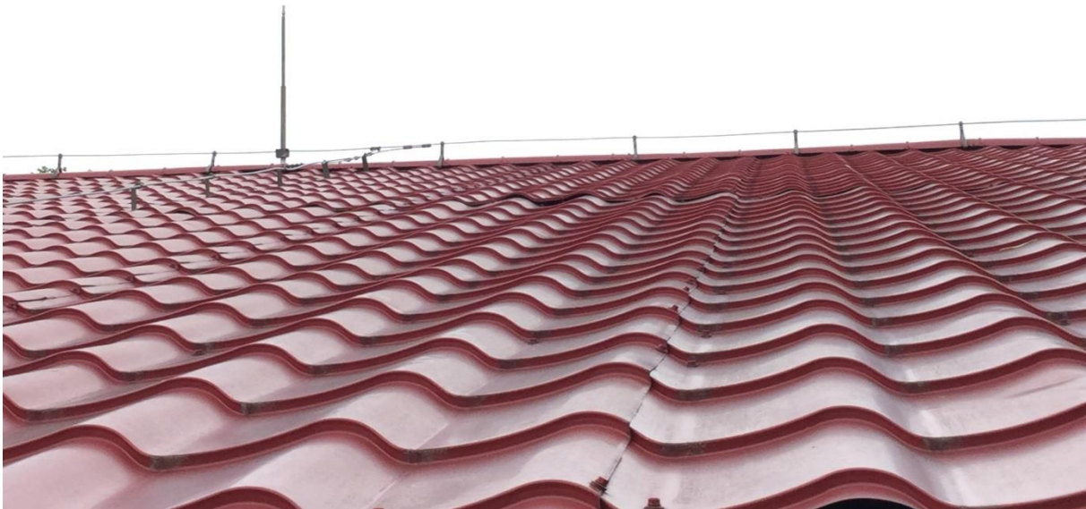
Obrázok č. 65 – strecha sedlová – Jednotlivé kusy strešnej krytiny na niektorých miestach nie je dostatočne prekryté a pritlačené k susednej časti krytiny
