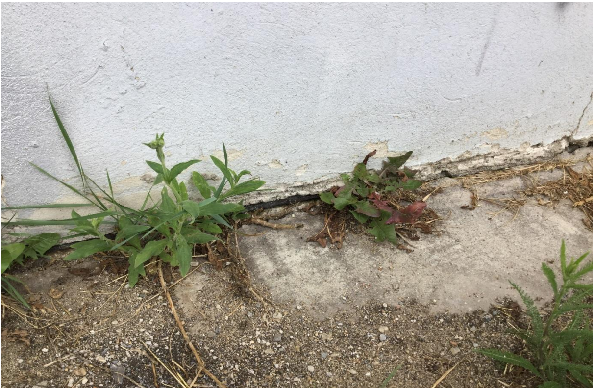
Obrázok č. 54 – západná fasáda – Izolovanie objektu proti vode a zemej vlhkosti je pravdepodobne iba vodorovnou asfaltovou hydroizoláciou.
