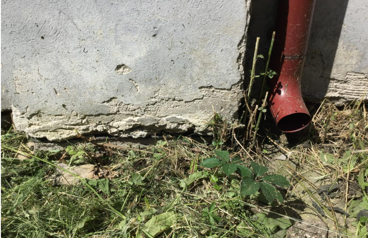
Obrázok č. 53 – západná fasáda – v okolí objektu na niektorých miestach okapové chodníky sú oproti pôvodnému terénu prepadnuté, oddelené od obvodového muriva, čím neplnia funkciu odvádzania vody od objektu
