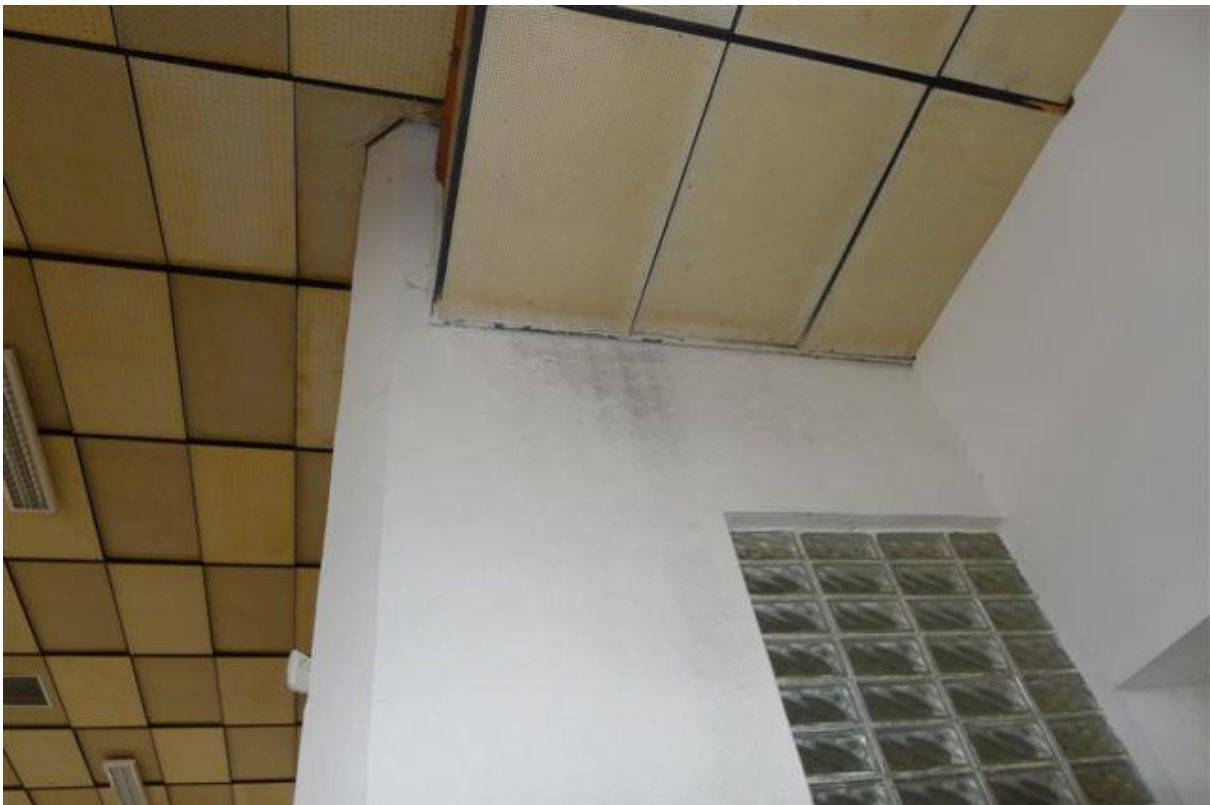
Obrázok č. 22 – M.č.1.18 – spoločenská sála – stropy po zatekaní na stenách a strope – opraviť maľby a povrchy pohľadov
