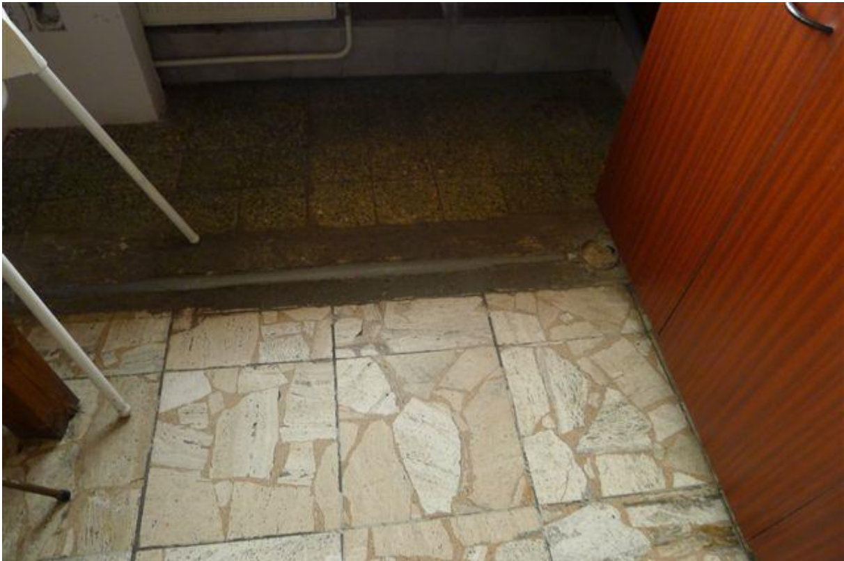
Obrázok č. 42 – M.č.2.08 – reštaurácia – nefunkčná podlahová vpusť, nevhodne umiestnená, dlažba je bez protišmykovej úpravy
