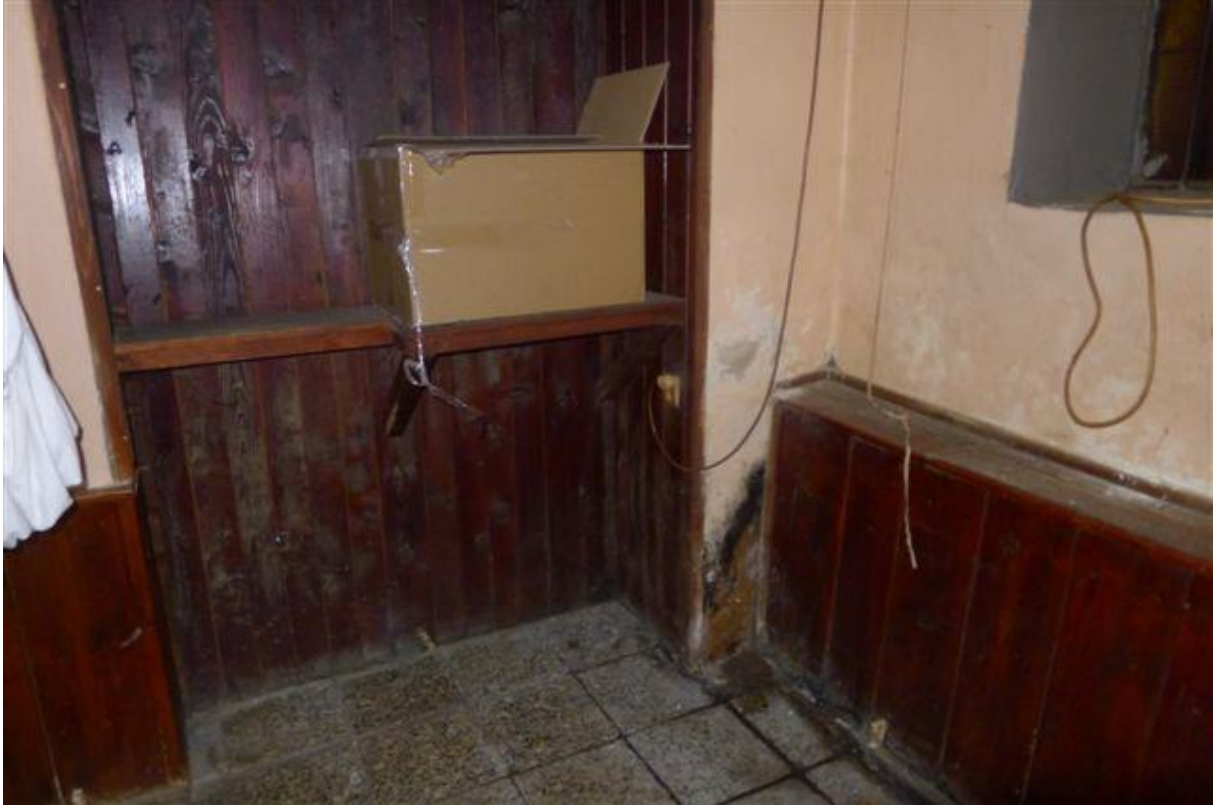
Obrázok č. 7 – M.č.0.06 – klubovňa – svetlá výška 2050mm nevyhovujúca pre tento druh priestoru, povrchy stien a podlahy sú v nevyhovujúcom stave
