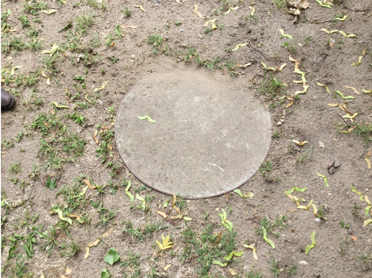
Obrázok č. 75 – Kanalizačné poloklopy neprístupné – preveriť osadenie lapača tukov z kuchýň objektu
