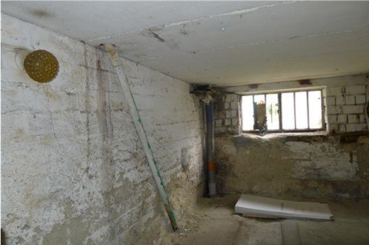
Obrázok č. 1 – M.č.0.01 – sklad, priestor bez povrchových úprav, zavlhnutý a zlom technickom stave – pre riadne využitie je potrebné prehĺbenie priestoru, aby sa zvýšila svetlá výška, zaizolovanie, výmena okien a realizácia nových povrchových vrstiev
