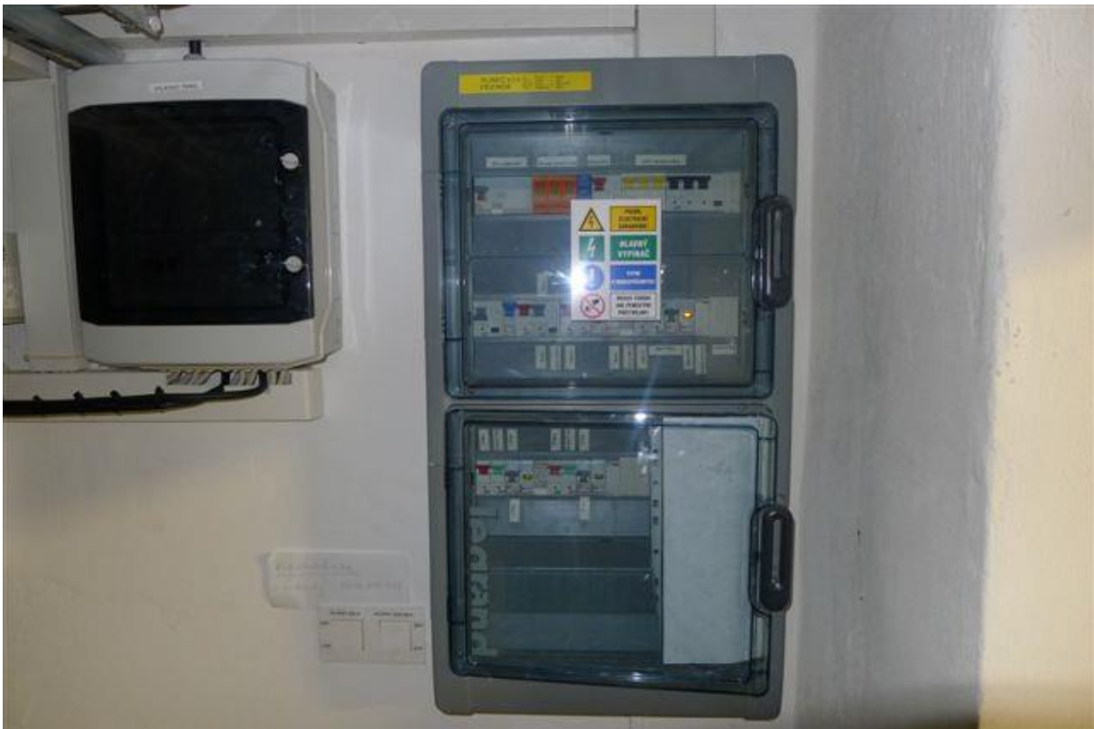
Obrázok č. 50 – M.č.1.02 – strojovňa VZT – rozvádzač elektro pre VZT
