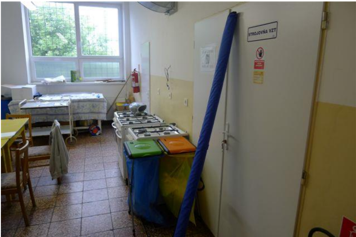
Obrázok č. 12 – M.č.1.03 – kuchyňa – povrchy stien poškodené sú potrebné nové obklady, dlažby sú nevyhovujúce z dôvodu protišmykovosti pre tento priestor – nové dlažby
