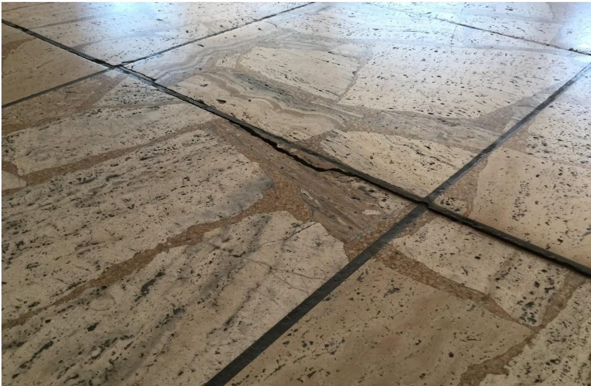
Obrázok č. 60 – vstupná hala – podlaha vo vstupnej hale na 1.NP pri stena zo strojovňou VZT prepadnutá, špárovanie v niektorých miestach je poškodené, vplyvom sadnutia podlahy
