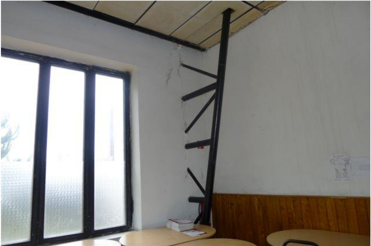
Obrázok č. 25 – M.č.1.18 – spoločenská sála – praskliny pri nosnej konštrukcii stropu a detail kovových okien, ktoré sú nefunkčné – je potrebná výmena
