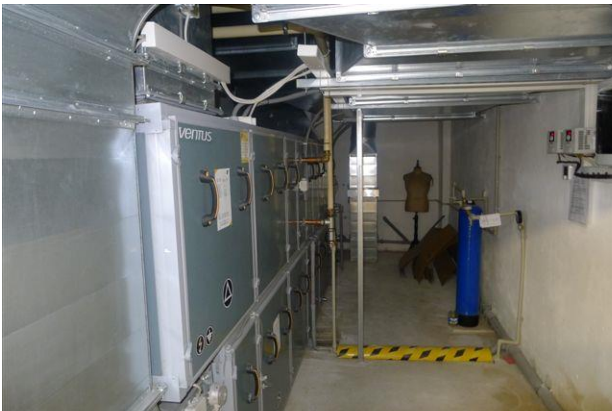
Obrázok č. 10 – M.č.1.02– strojovňa vzduchotechniky
