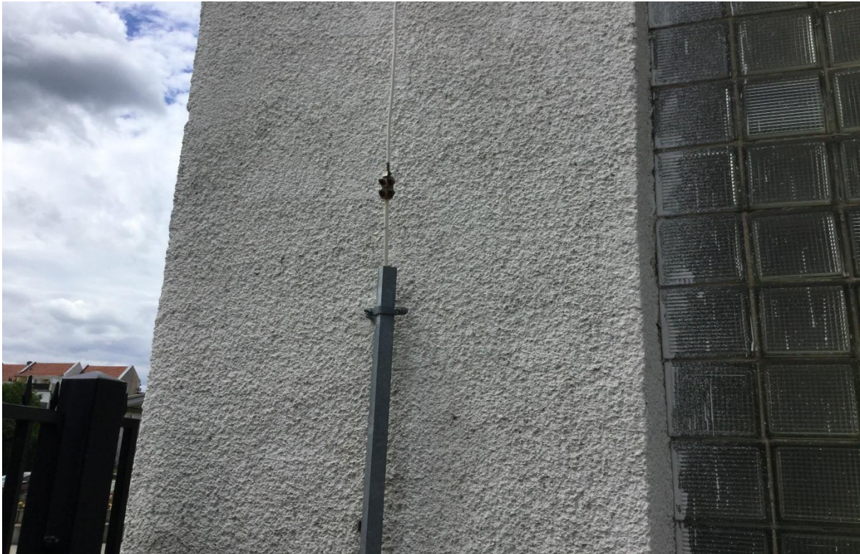
Obrázok č. 67 – fasáda – Bleskozvod na zvislých stenách nespĺňa súčasné platné normy
