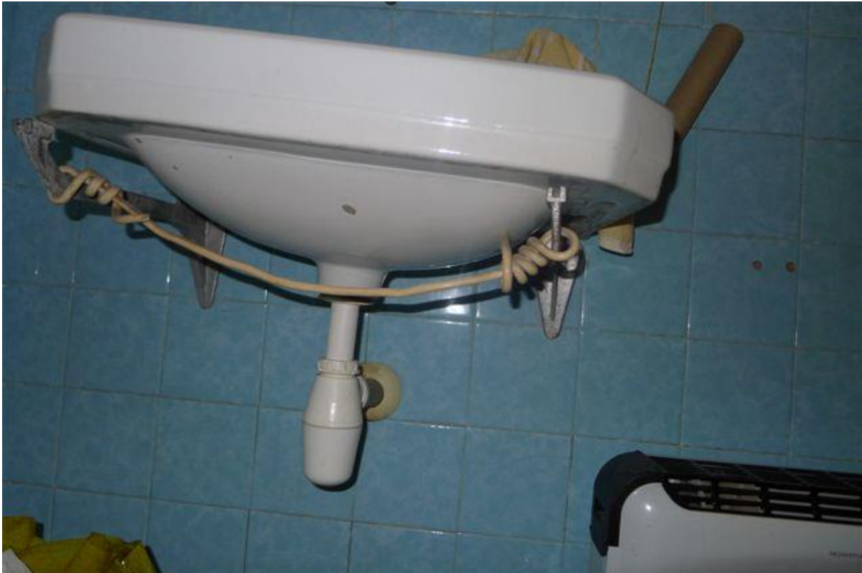
Obrázok č. 31 – M.č.1.22 – detail poškodeného závesu umývadla
