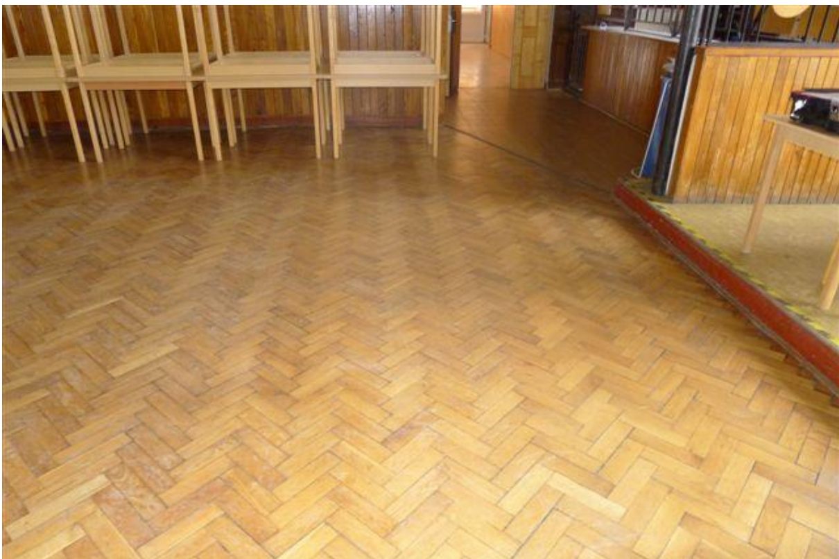
Obrázok č. 24 – M.č.1.18 – spoločenská sála – podlaha je uvoľnená, potrebná jej sanácia podľa detailného posúdenia, najpravdepodobnejšia kompletná výmena
