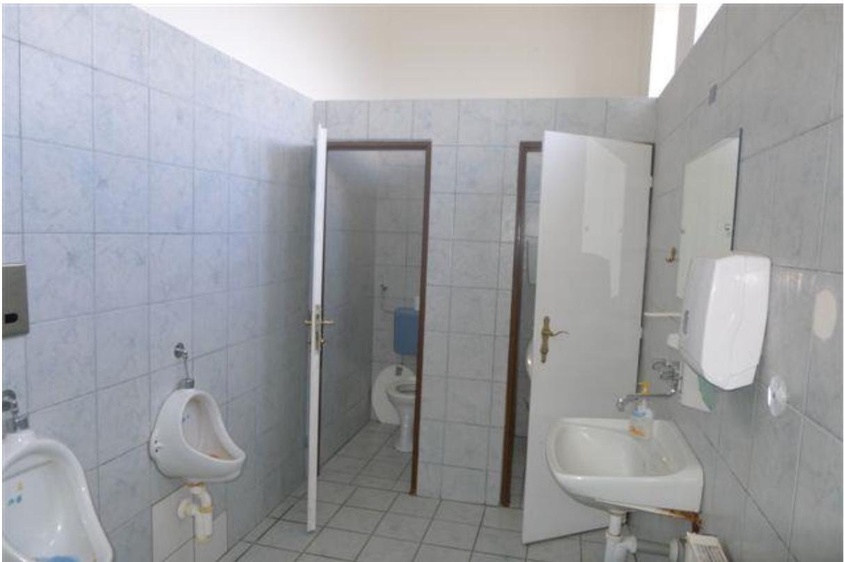
Obrázok č. 36 – M.č.2.02 – WC muži – detail pisoárov a umývadla – výška podlahy nie je v rovnakej úrovni ako na chodbe – možnosť úrazu
