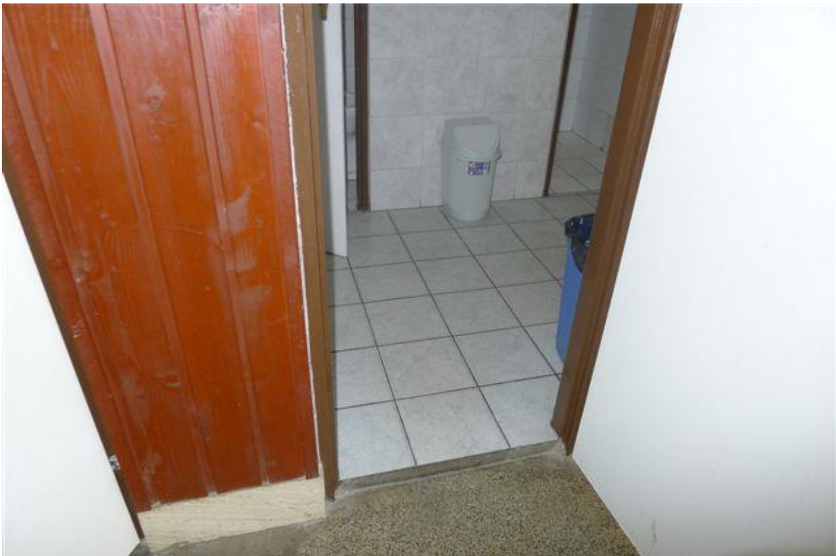
Obrázok č. 38 – M.č.2.03 – detail výškového rozdielu podlahy – medzi chodbou a WC – možnosť úrazu
