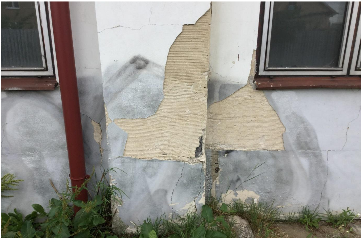
Obrázok č. 58 – západná fasáda omietka na niektorých miestach opadaná vplyvom poveternostných podmienok a slnečného žiarenia
