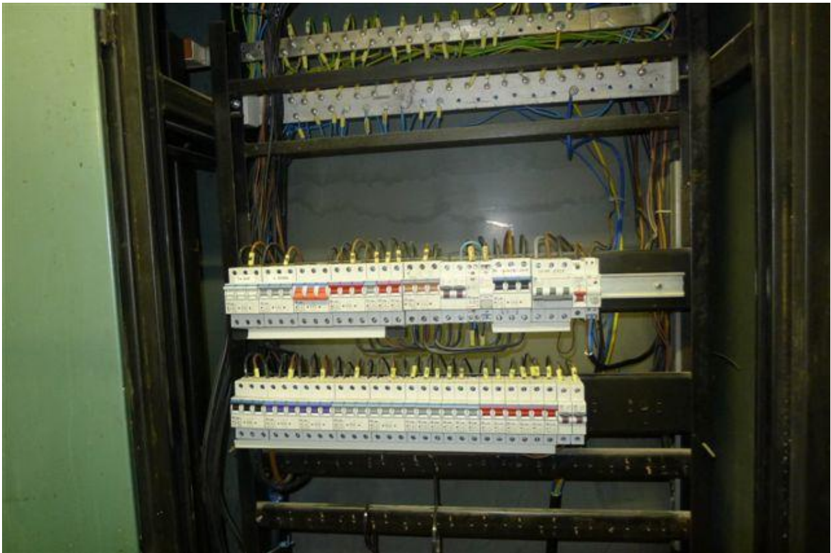
Obrázok č. 30 – M.č.1.21 – elektrorozvodňa – časť bufetu – detail rozvádzača v nevyhovujúcom stave – chýbajúce kryty káblových rozvodov
