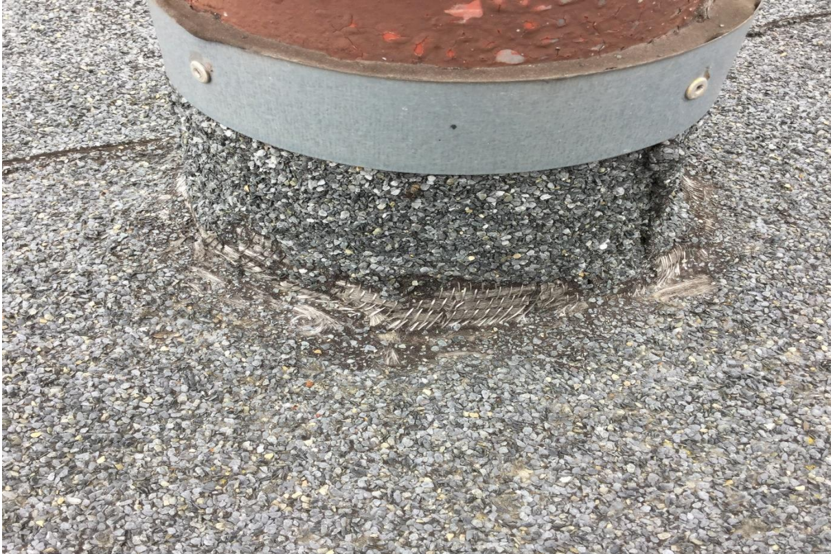
Obrázok č. 63 – strecha pultová – Detaily prestupov strechy, vyvedenia hydroizolácie na atiku je riešené izoláciou s hrubozrnným posypom, miestach zohnutia je izolácia poškodená, viditeľná výstužná vrstva
