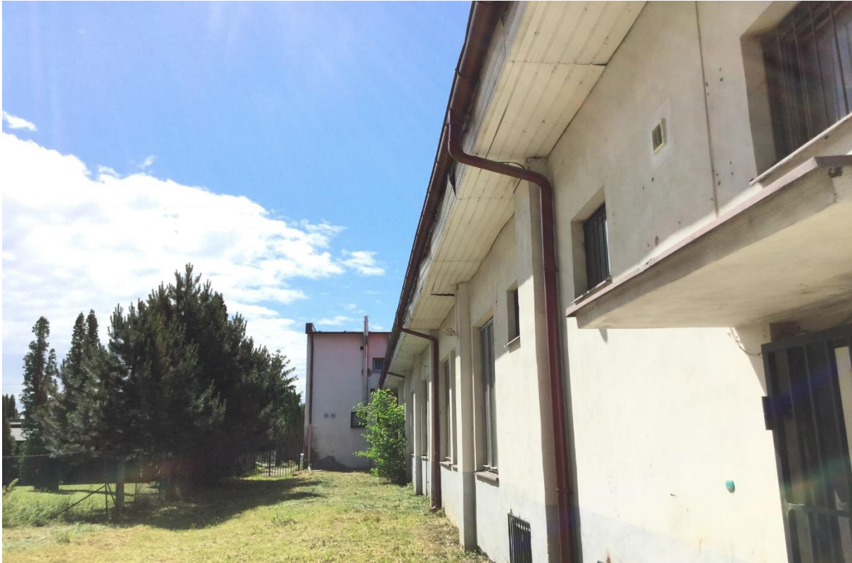
Obrázok č. 59 – západná fasáda - podbitie okapovej časti strechy tvorenej plastovým obkladom je na niektorých miestach uvoľnené a vplyvom slnečného žiarenia aj zdeformované.
