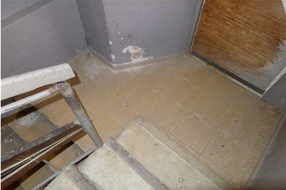
Obrázok č. 5 – M.č.0.05 – schodisko – značne poškodené povrchy stien a podlahy bez výstražného značenia prvého a posledného stupňa
