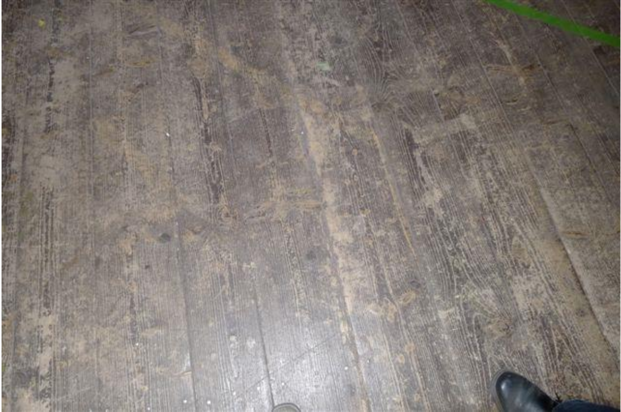
Obrázok č. 29 – M.č.1.19 – javisko – podlaha javiska vyžadujúca opravu
