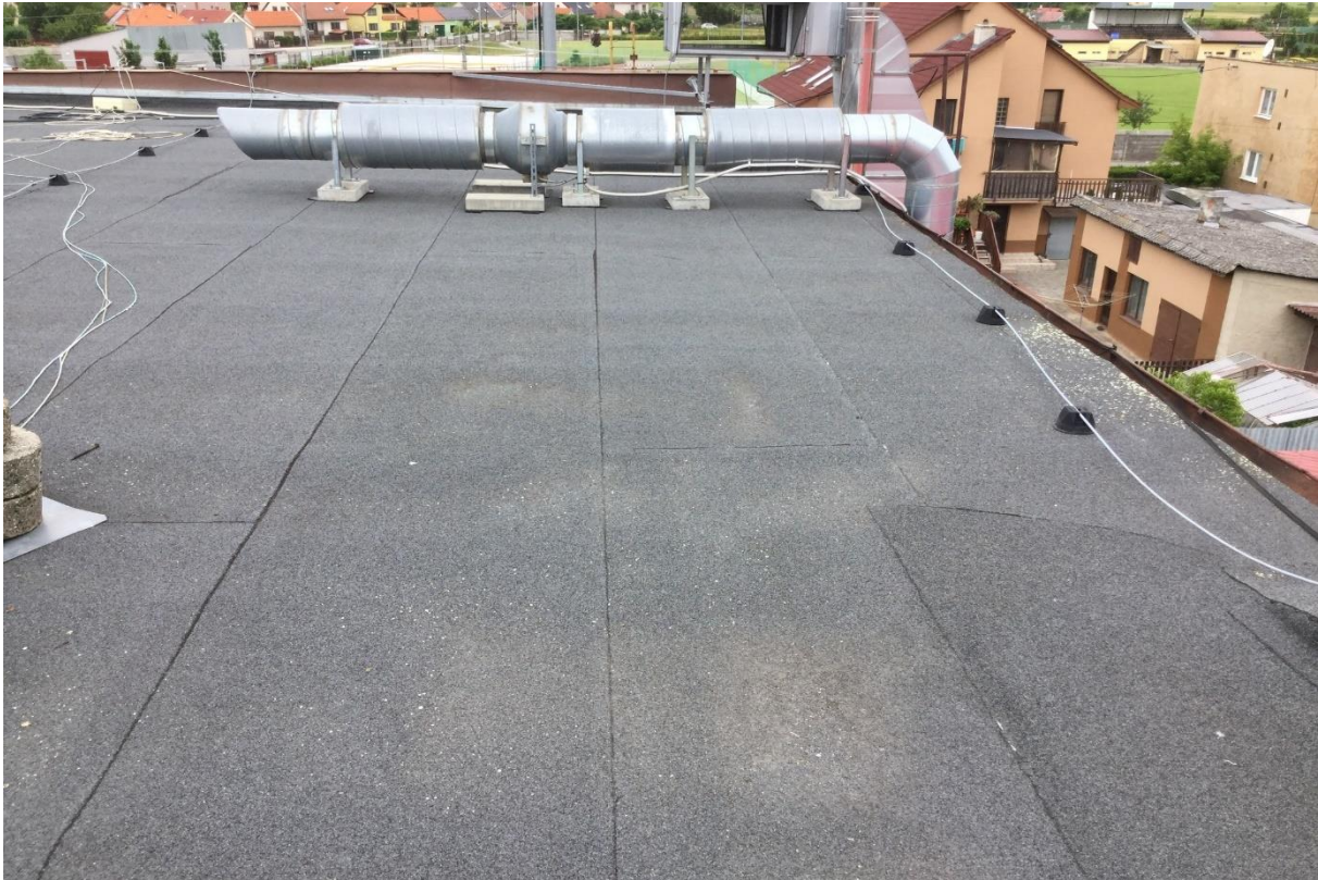
Obrázok č. 61 – strecha pultová – Hydroizolačná vrstva je po celej vrstve zvlhnená
