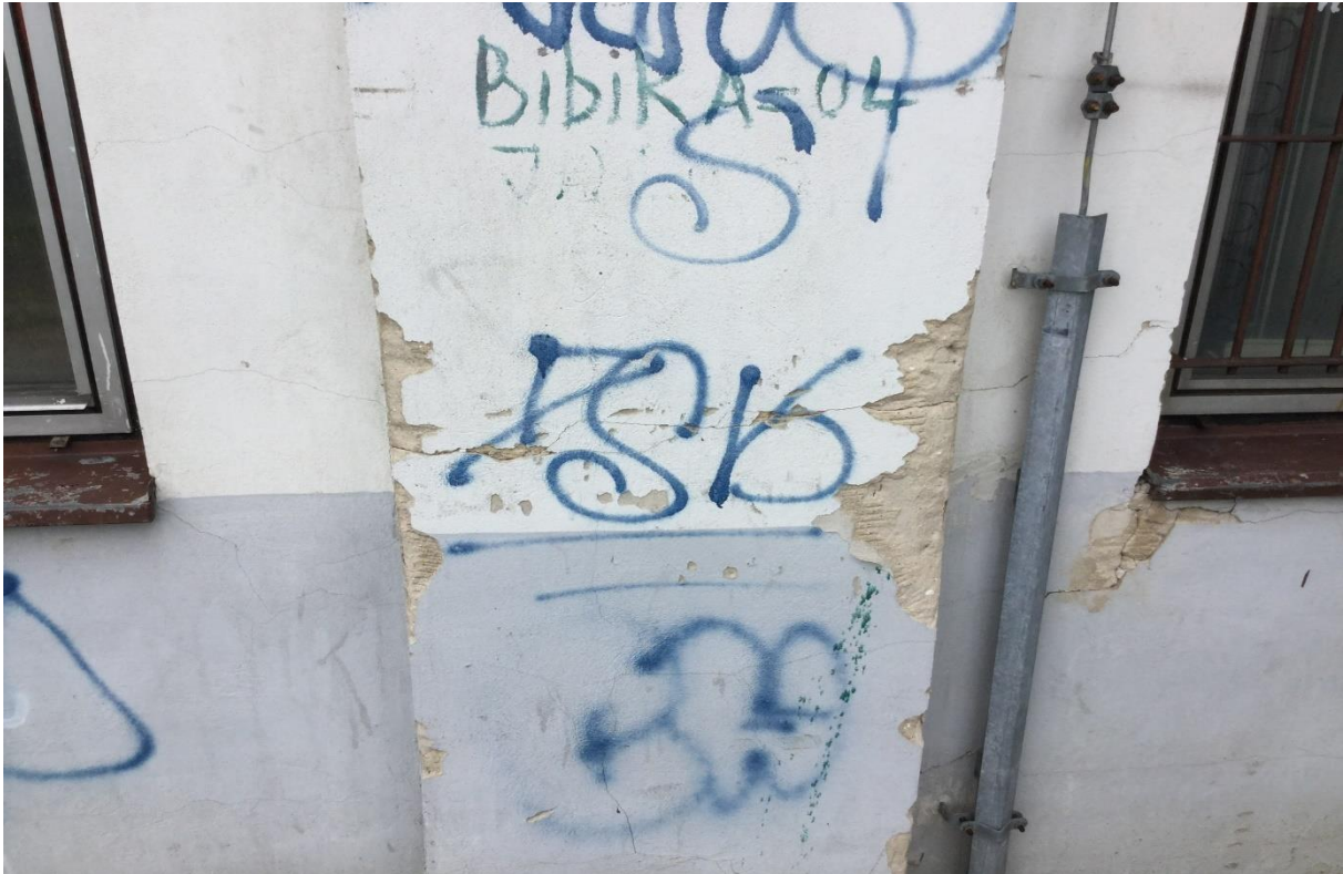
Obrázok č. 57 – západná fasáda – V miestach obmurovania ocelevej priehradovej rámovej konštrukcie je murivo popraskané vplyvom rôzneho sadania rámovej konštrukcie a výplňového muriva ako aj inej teplotnej rozťažnosti materiálov.
