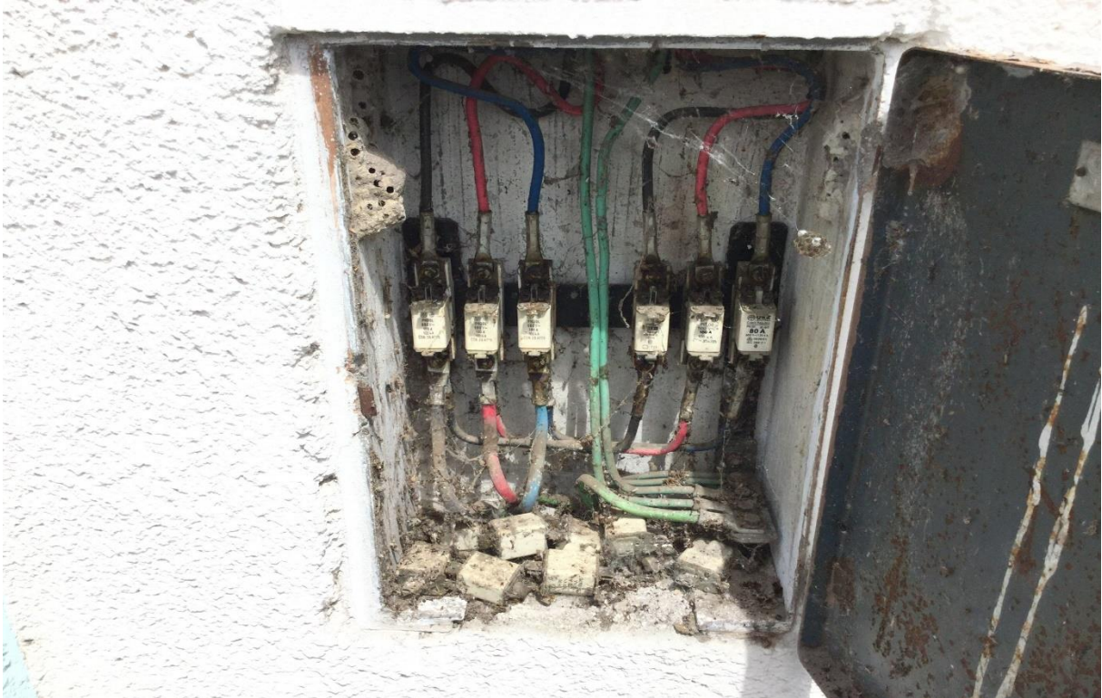
Obrázok č. 71 – elektroinštalácia - Rozvádzače/poistkové skrine pôvodné – nevyhovujúce
