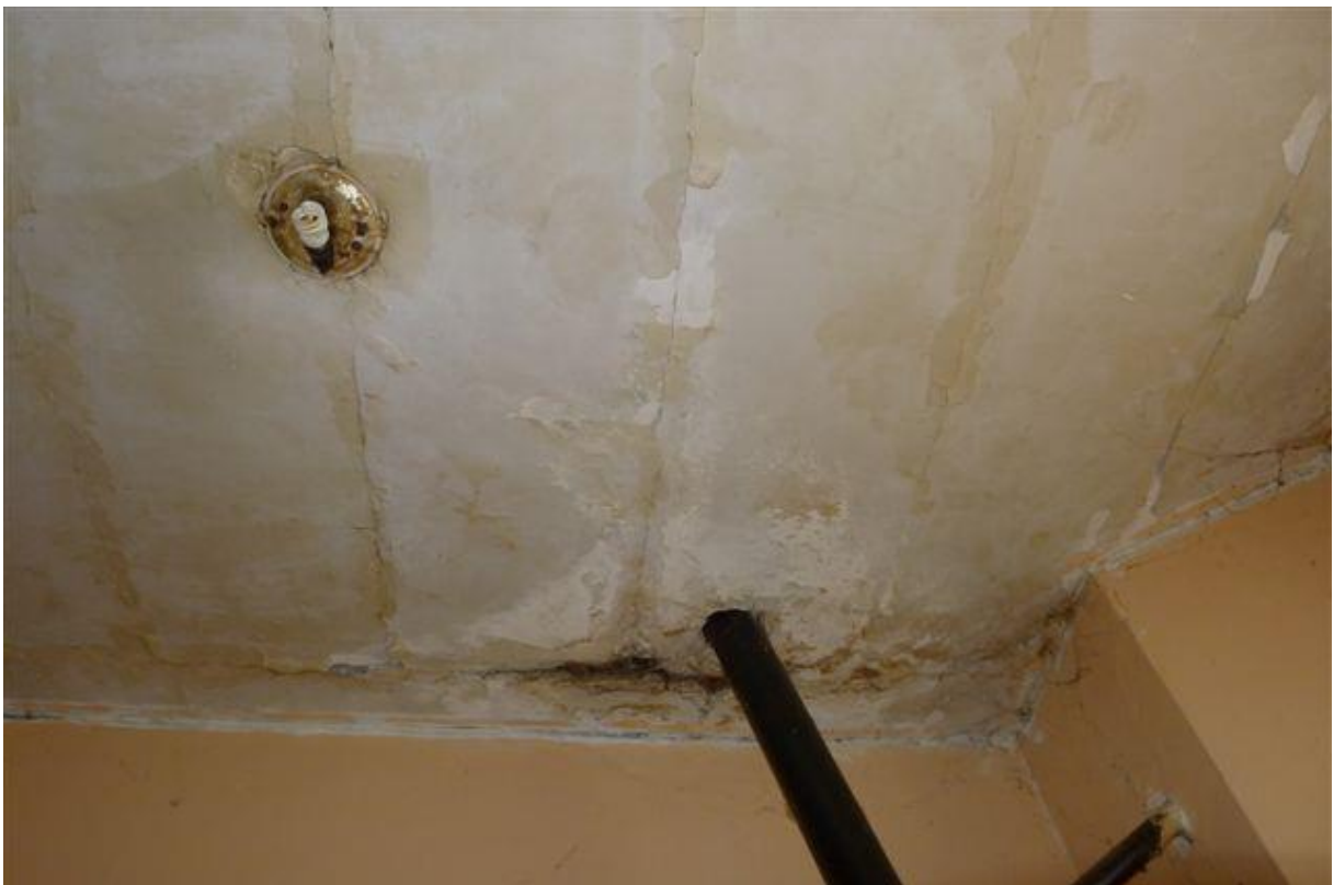
Obrázok č. 6 – M.č.0.05 – schodisko suterén – stopy značne poškodené vlhkosťou a zatekaním – hrozí zrútenie podhládu, elektroinštalácia v tomto prostredí je nebezpečná
